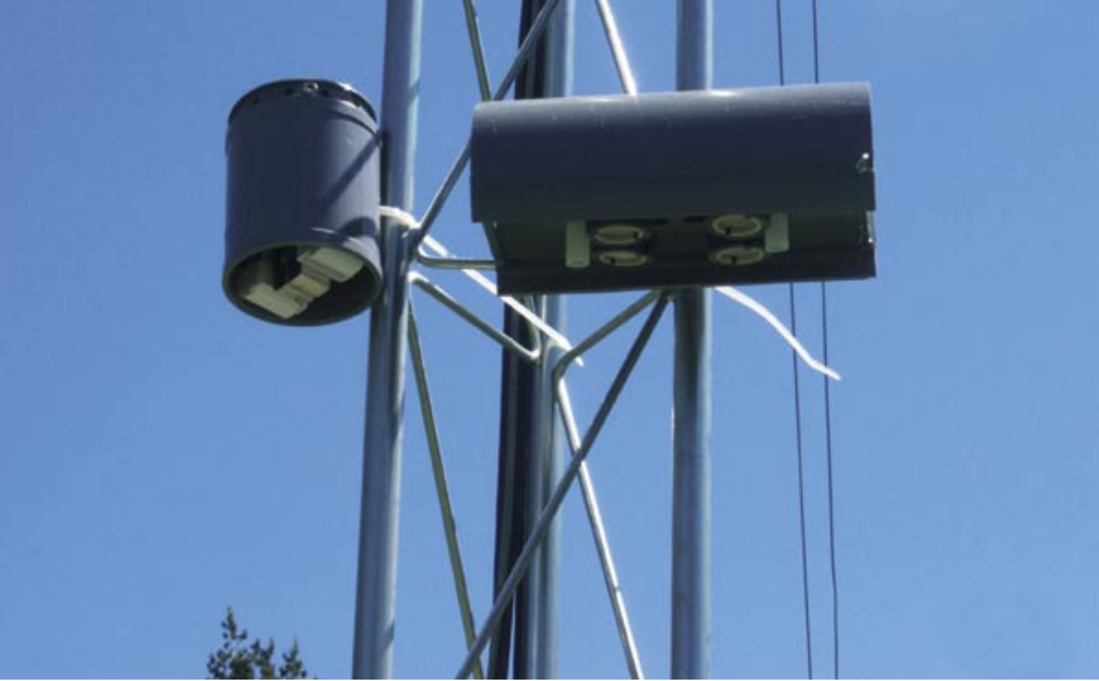
Échantillonneurs passifs installés en Espagne
